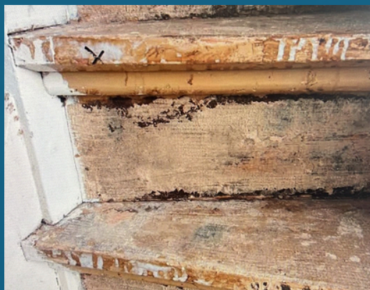
Voorbeeld NIET rechte trapneuzen en oneffenheden Foto 3
