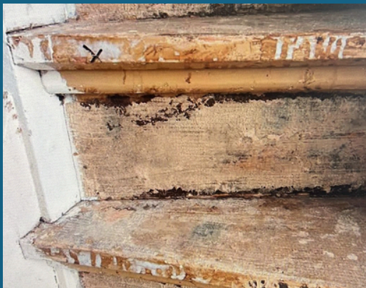
Voorbeeld NIET rechte trapneuzen en oneffenheden Foto 3
